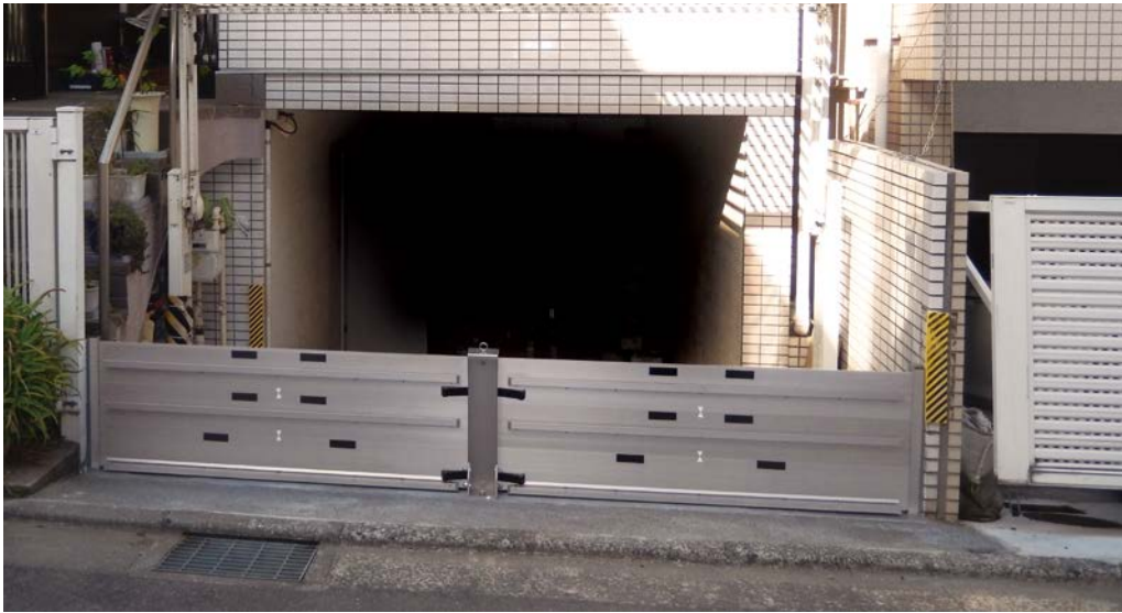
オクダケ (2連装) ・個人邸 半地下駐車場 (外付納まり)
